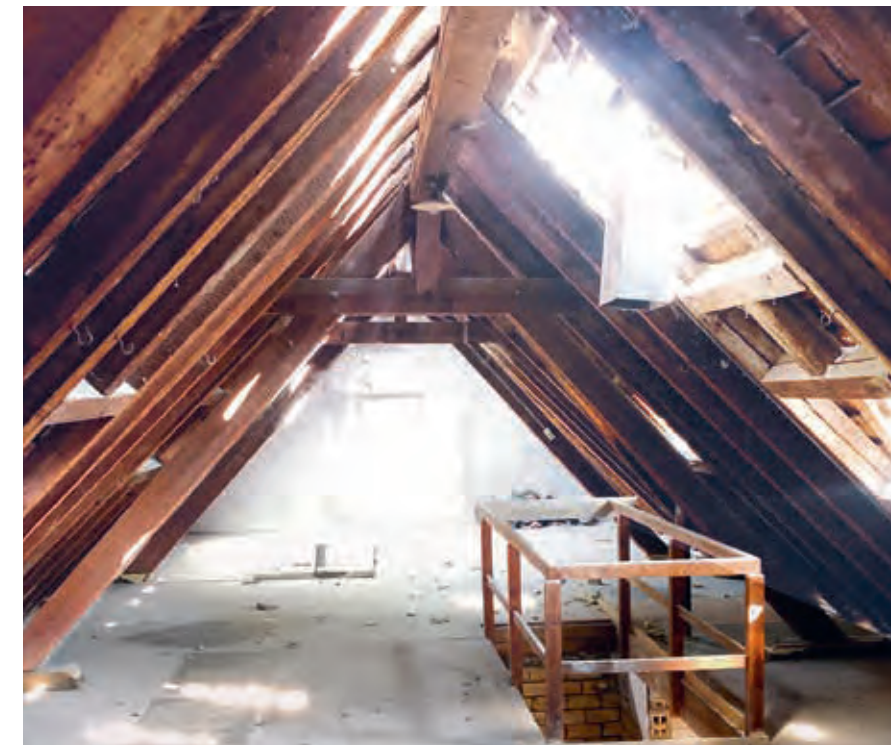
Engineering: Beratung und Erarbeitung von Detaillösungen, Systemplanung Verputz und Trockenbau, Submissionserstellung, Sicherstellung der Schall- und Brandschutzkonformität inkl. Abnahmen.
